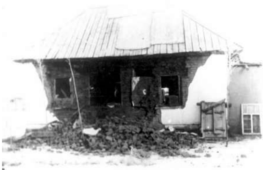
Рис. 2.3.3в. Обрушившийся кирпичный дом
