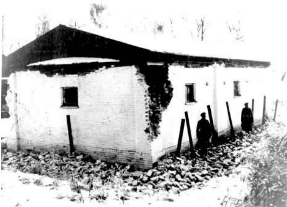
Рис. 2.3.4в. Здание Военных казарм после землетрясения
