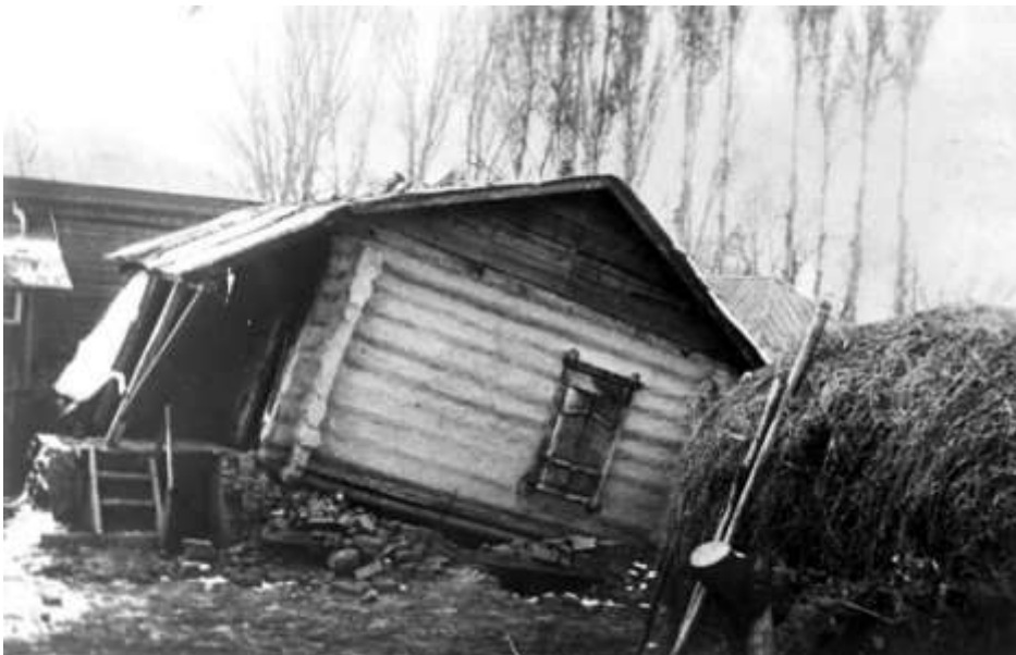
Рис. 2.3.5. Перекос деревянного дома (срубa) в результате землетрясения
